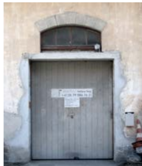
130 Mesocco. Non sonostate rispettate le caratteristiche dell'edificio
