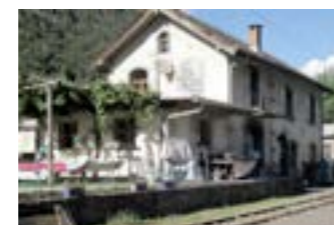
106 Grono. L'edificio è ancora abitato, ma necessita di interventi sostanziali. Alla facciata meridionale è anteposto un pergolato.
