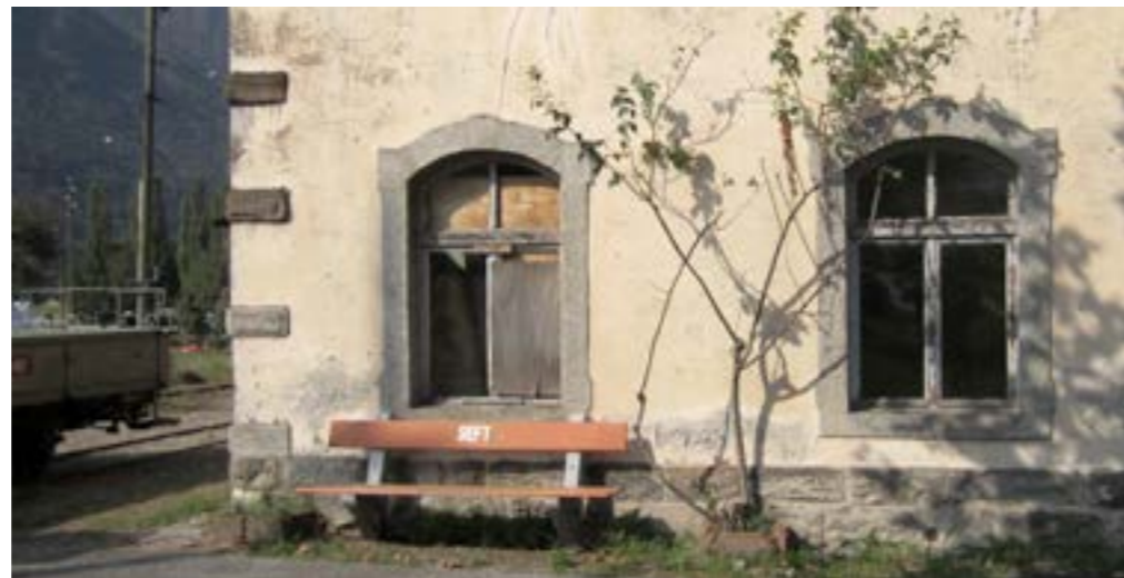
128 San Vittore. Particolare della facciata est consumata dal tempo
