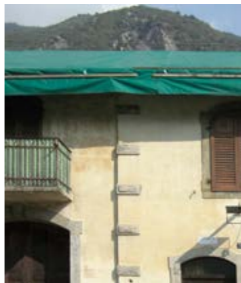
129 San Vittore. Degrado per mancata manutenzione (tetto)e
