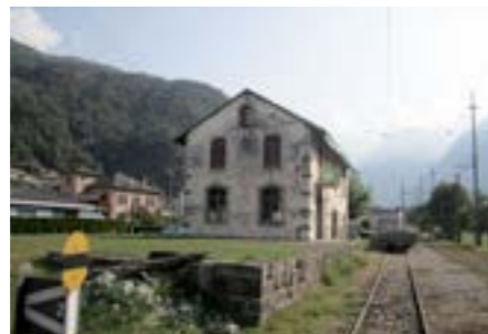
104 San Vittore. Lo stabile si trova in condizioni critiche: segni di degrado e copertura provvisoria.
